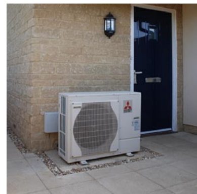
Fig. 24 Air source heat pump fan unit
